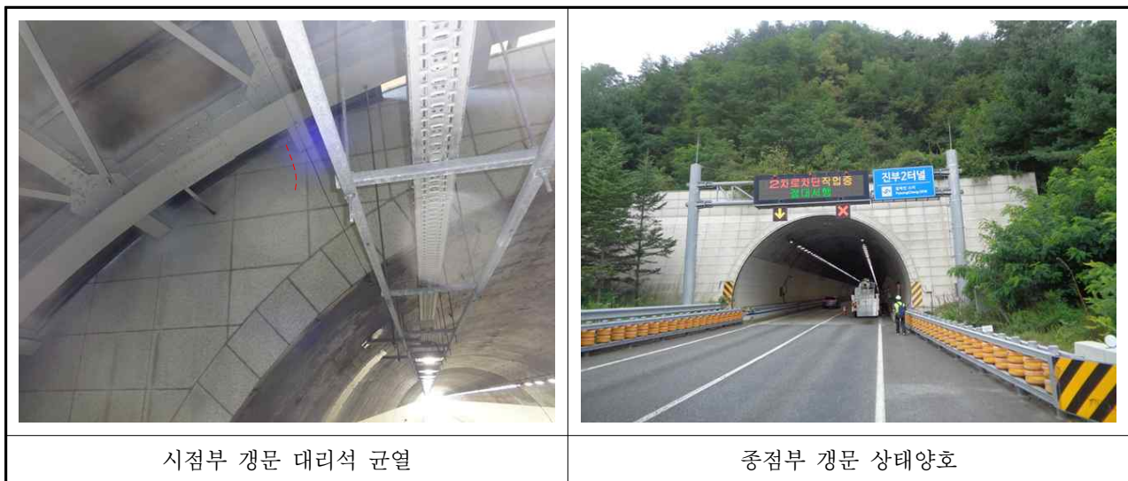
【사진 3.8】 갯문 손상현황
