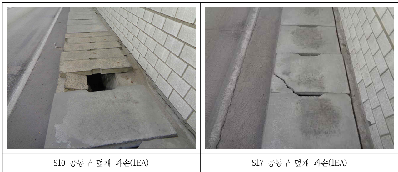
【사진 3.12】 공동구 손상현황
